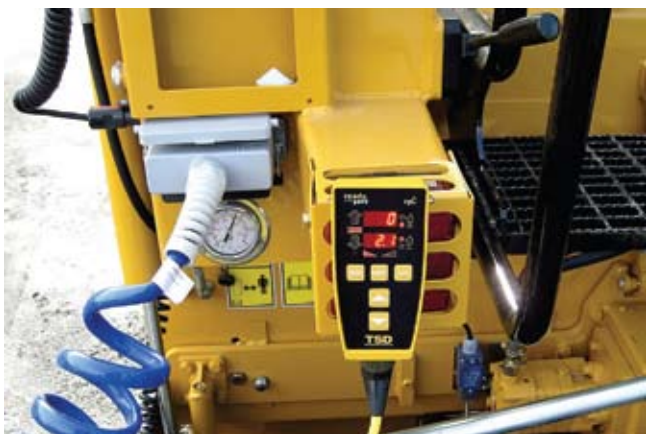
Фото 1. Пульт управления нивелирующей системы Topcon ReadyPave асфальтоукладчика
